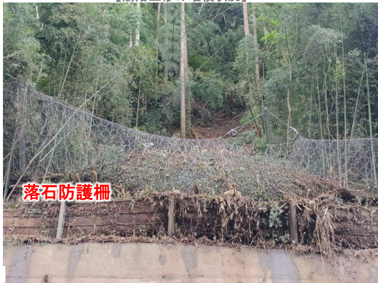
【崩落土砂の堆積状況】
