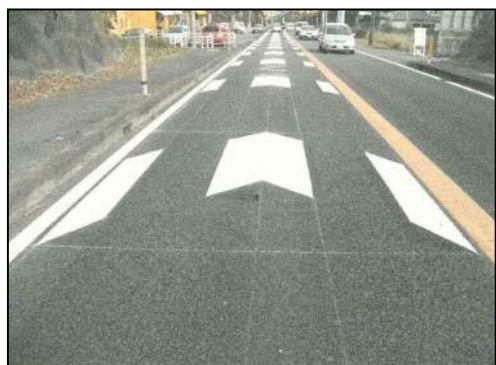
<設置状況写真>
