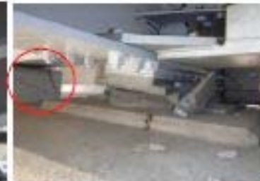
写真-6 支承の破損の状況
