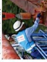
ケーブルの力 パー部の腐食
