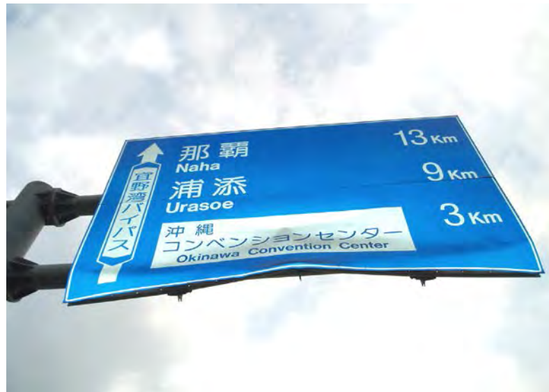
異常変形 (車両衝突)
