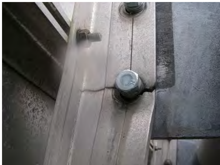
き裂損傷 (車両衝突)
