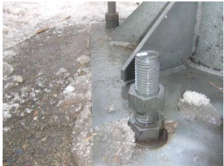
ボルトの緩み (施工不良)
