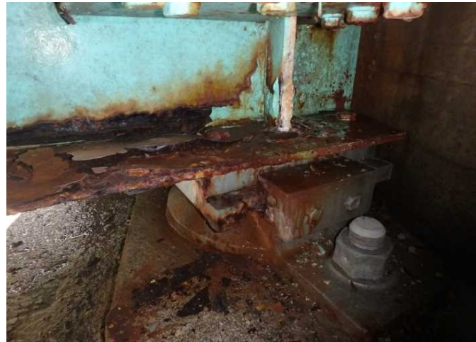
地方自治体管理 主桁腐食
