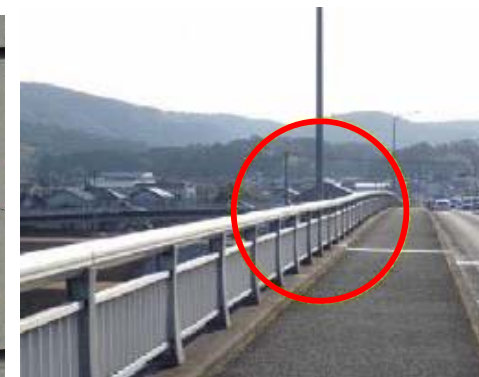
▲中央ヒンジ部の垂れ下がり
