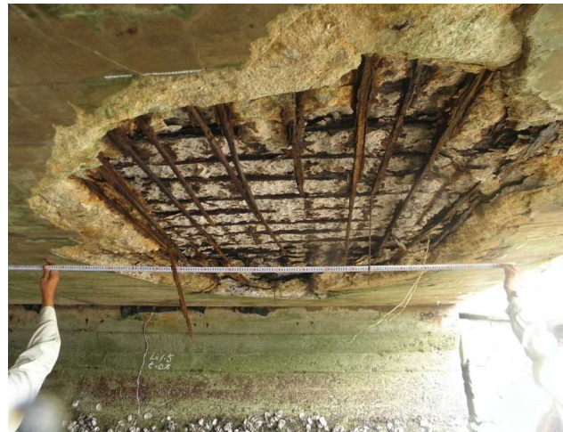
地方自治体管理 床版鉄筋露出
