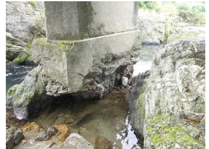
地方自治体管理 橋脚洗掘
