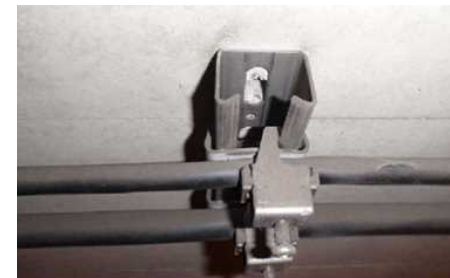
アンカーボルトの脱落の例
