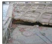
クラックが生じた河川護岸
