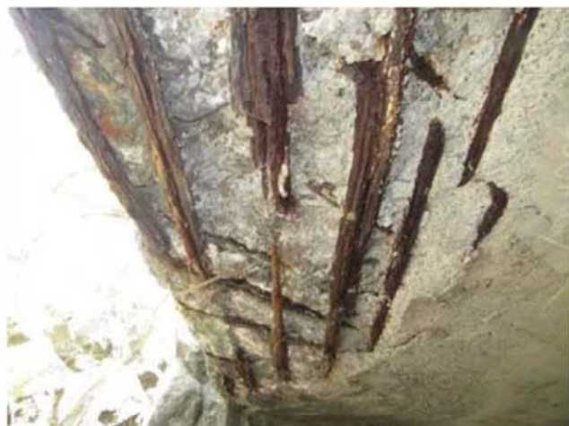
国管理 床版鉄筋露出 ※床版：橋の裏側
