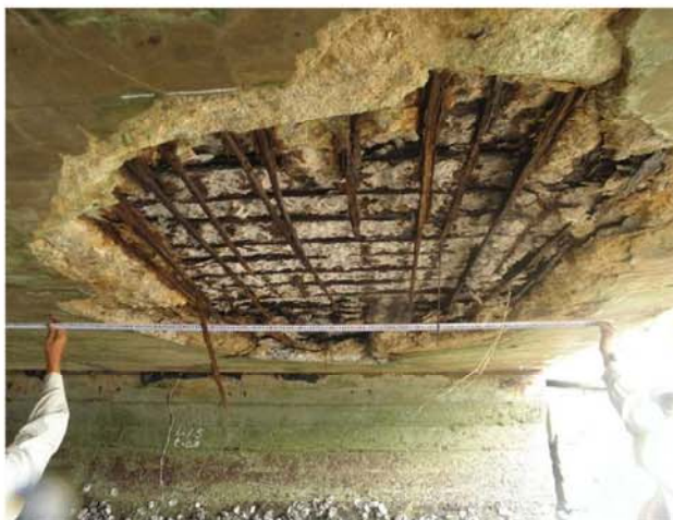
地方自治体管理 床版鉄筋露出
