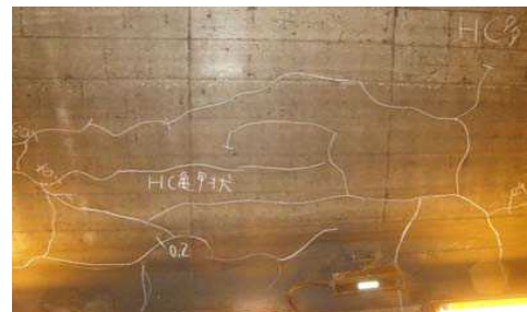
覆工の変状(ひび割れ)
