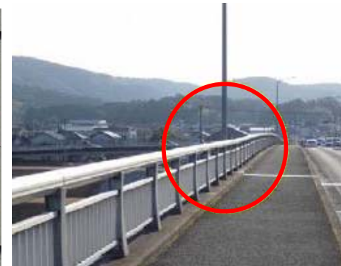
▲中央ヒンジ部の垂れ下がり
