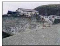
老朽化した海岸堤防
