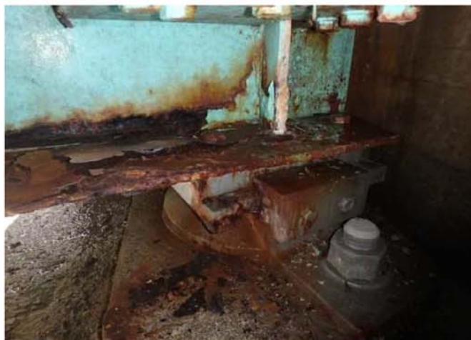
地方自治体管理 主桁腐食
