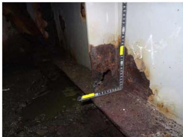
国管理 主桁腐食・欠損
