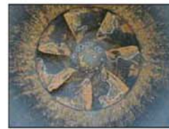
腐食した排水ポンプ場の羽根車
