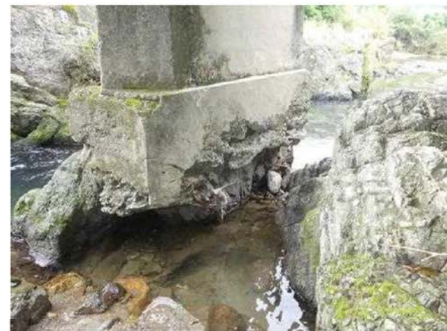
地方自治体管理 橋脚洗掘
