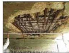
内部の鉄筋が露出した橋梁
