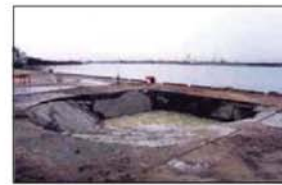
陥没した港湾施設のエプロン部分
