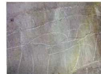
下部工のひび割れ
