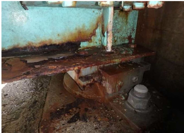
地方自治体管理 主桁腐食
