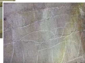
下部工のひび割れ
