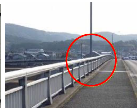
▲中央ヒンジ部の垂れ下がり
