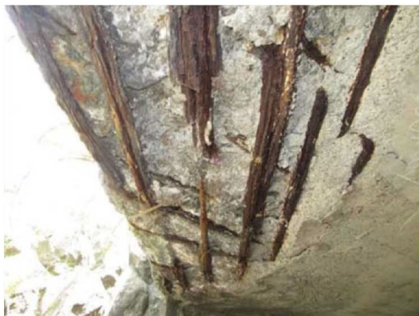
国管理 床版鉄筋露出 ※床版: 橋の裏側
