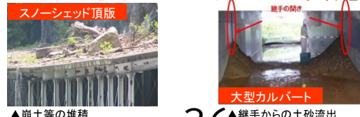
▲崩土等の堆積
