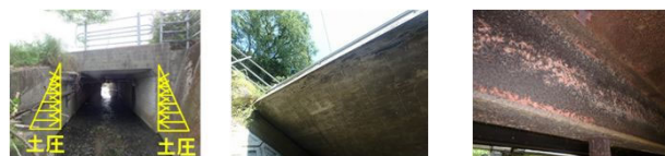
▲溝橋 変状項目
