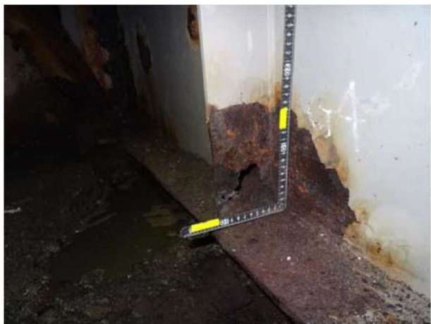
国管理 主桁腐食・欠損
