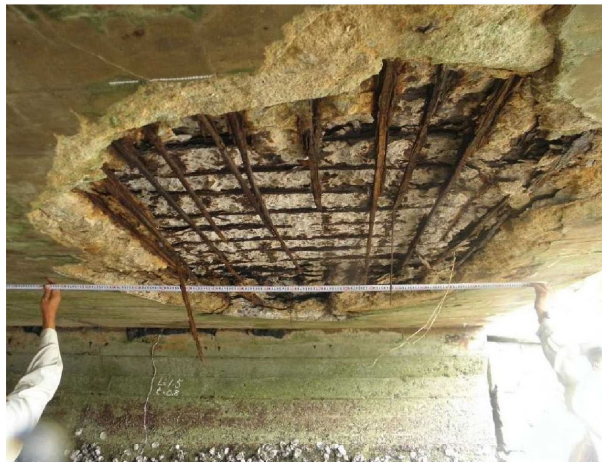
地方自治体管理 床版鉄筋露出
