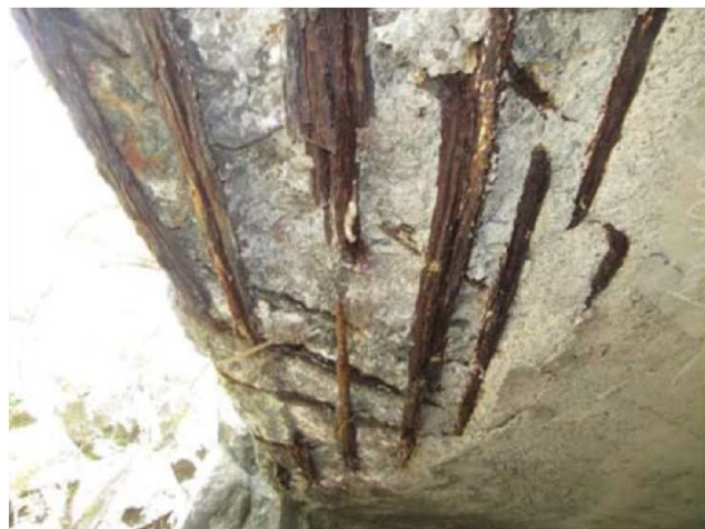
国管理 床版鉄筋露出
