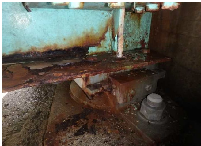
地方自治体管理 主桁腐食
