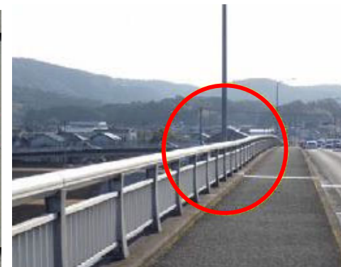
▲中央ヒンジ部の垂れ下がり
