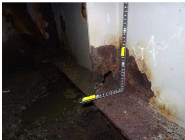
国管理 主桁腐食・欠損
