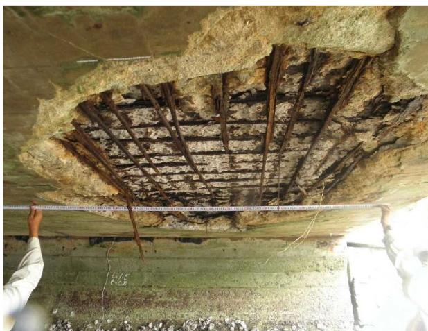
地方自治体管理 床版鉄筋露出
