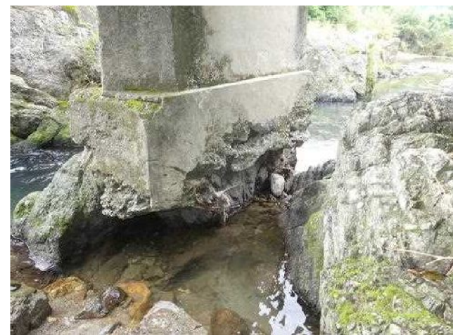
地方自治体管理 橋脚洗掘
