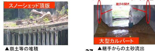
崩土等の堆積
