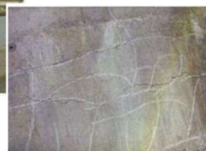
下部工のひび割れ
