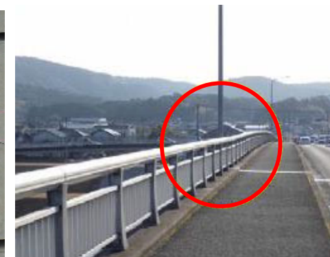
▲中央ヒンジ部の垂れ下がり
