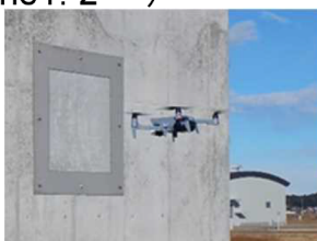
ドローンによる損傷把握
