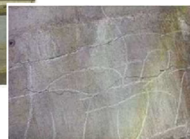
下部工のひび割れ
