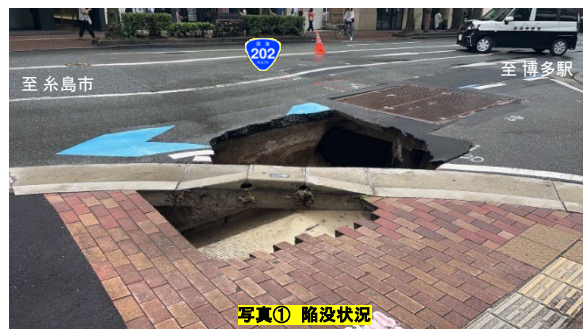
写真① 陥没状況
