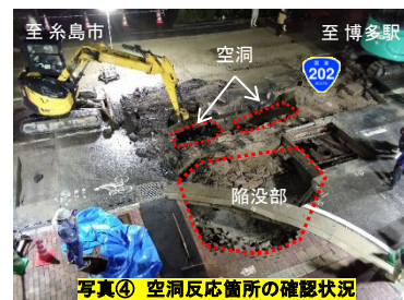
写真④ 空洞反応箇所の確認状況
