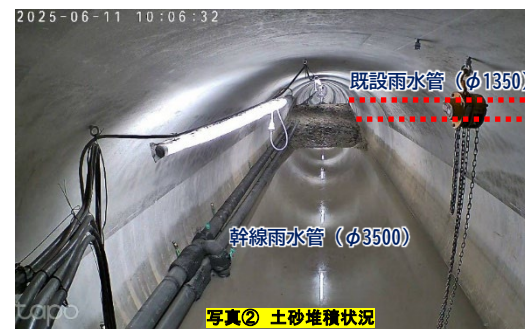
写真② 土砂堆積状況
