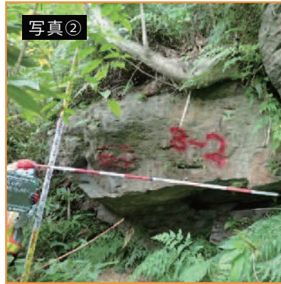
▲斜面の不安定な岩盤
