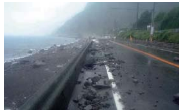
▲ 越波による被災状況 (H16.8.30) 始良市脇元白浜地区付近
