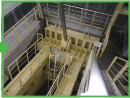
常用洪水吐き (コンジットゲート)
