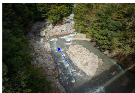
樺木砂防堰堤直下の状況 (令和4年9月29日撮影)
