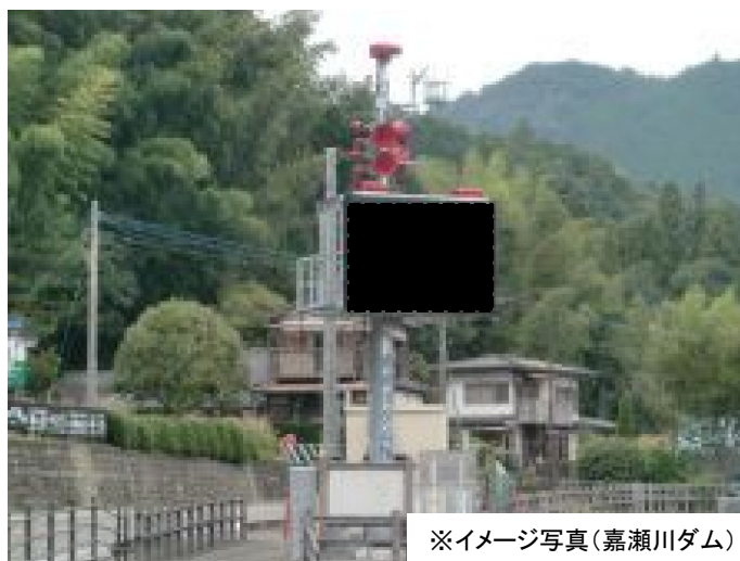
放流警報設備
