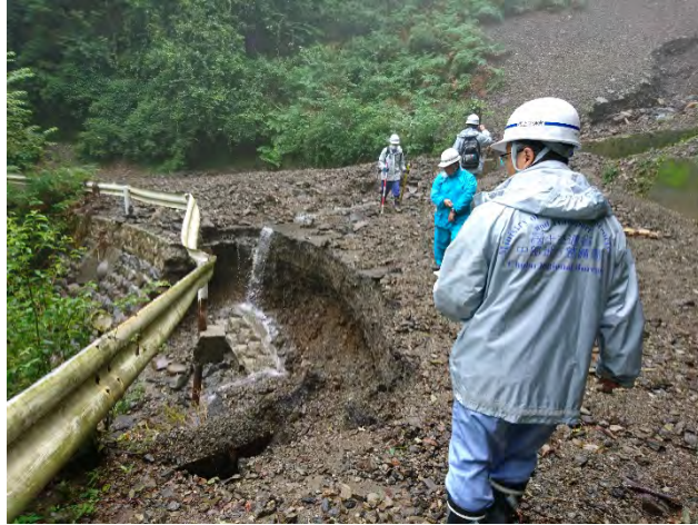
湯前町にて被災状況調査
