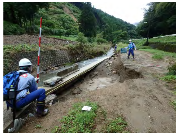
7/16 【河川班】被害状況調査（芦北町）
