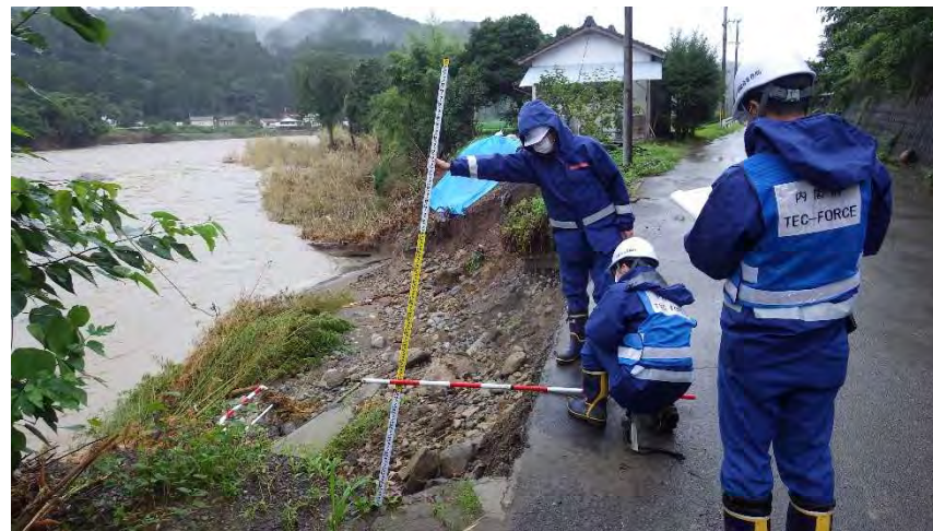
【被災状況調査】
