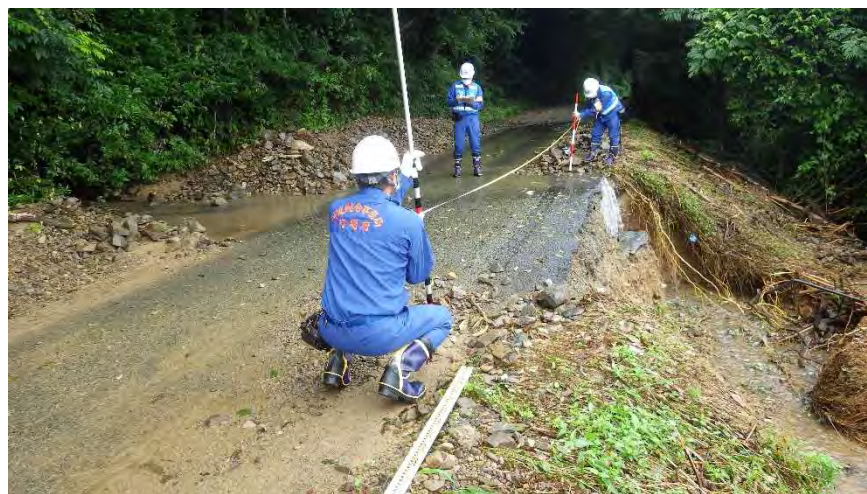
【被災状況調査】
