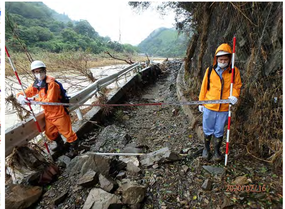
7/16 【道路班】被災状況調査（八代市）
