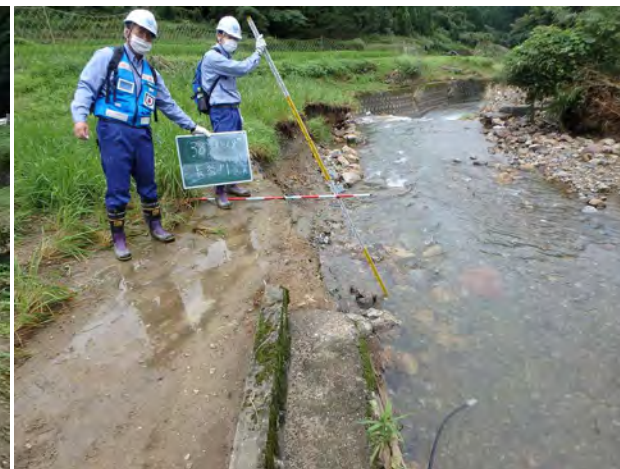
7/16 【河川班】被害状況調査（芦北町）
