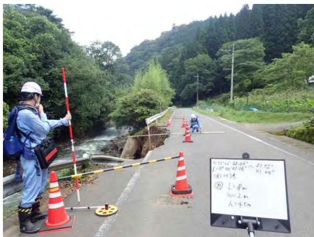
【応急対策班：被災状況調査（多良木町）】
