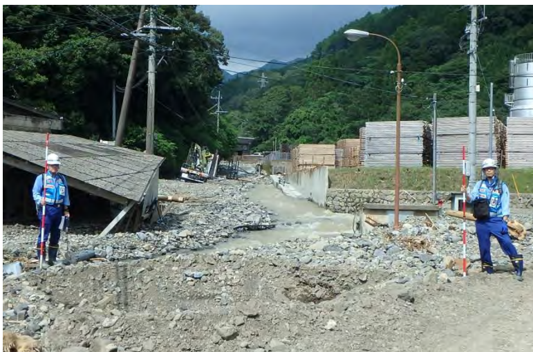
【球磨郡球磨村:被災状況調査(砂防班)】
