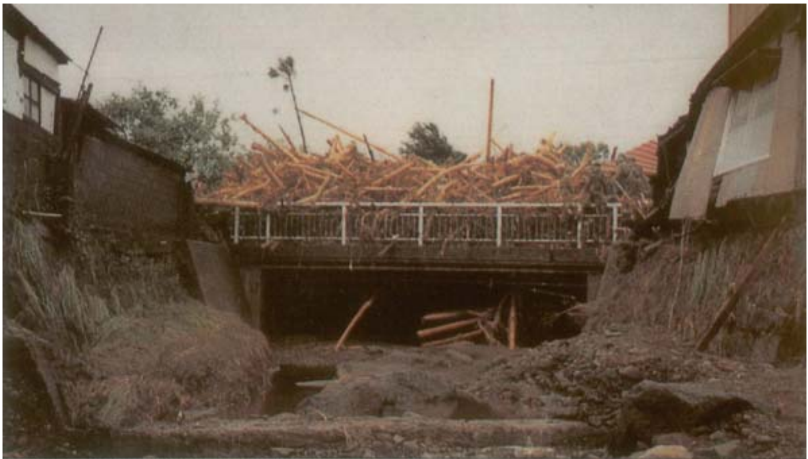
白川水系黒川 松原橋(国道57号,阿蘇郡一の宮町) の流木の状況(平成2年7月洪水)
