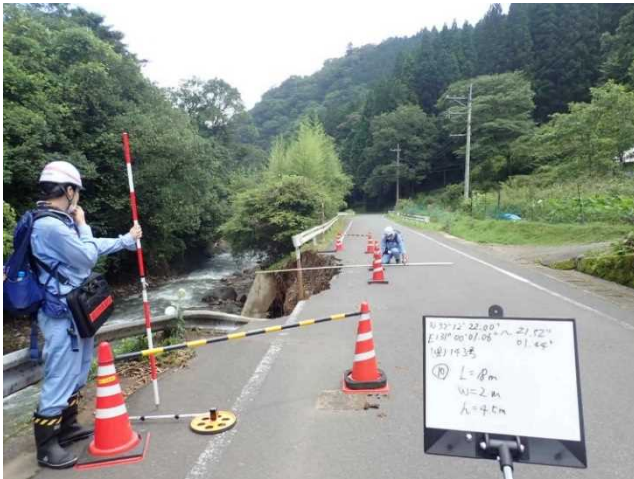
【応急対策班：被災状況調査（多良木町）】
