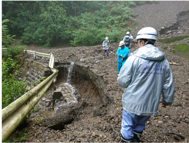
湯前町にて被災状況調査
