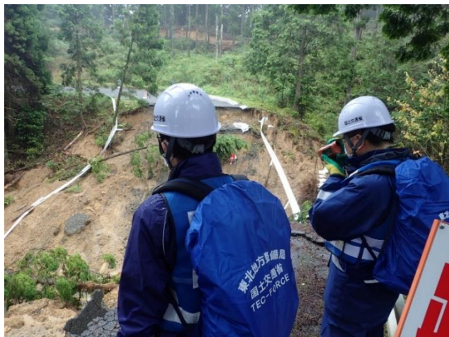
【応急対策班：被災状況調査（多良木町）】
