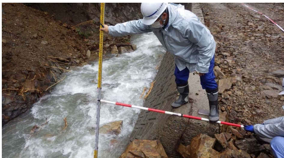
被災状況を調査（熊本県湯前町）
