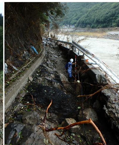
7/16 【道路班】被災状況調査 (球磨村)
