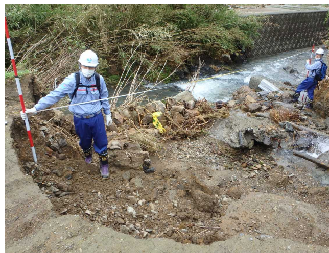
7/16 【河川班】被害状況調査(芦北町)
