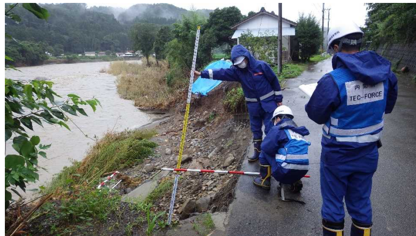
【被災状況調査】
