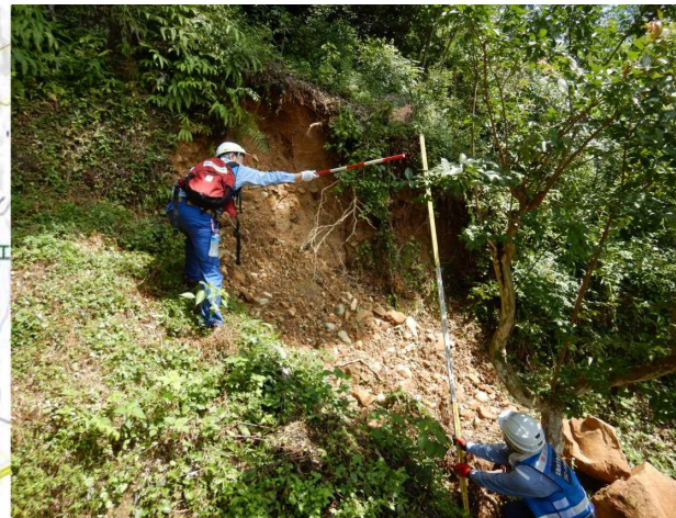
平山地先 現地状況 (小崩落の状況確認)
