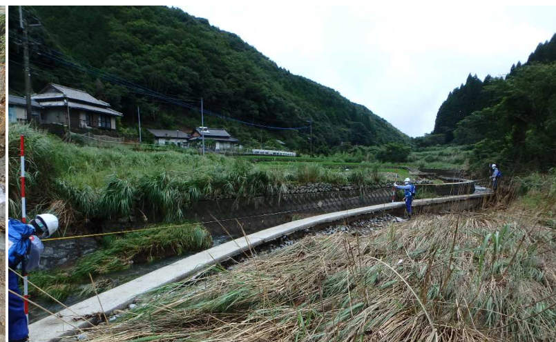
7/16 【河川班】被害状況調査(芦北町)
