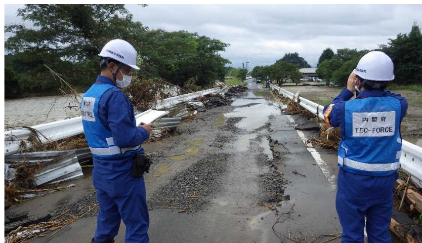
【被災状況調査】
