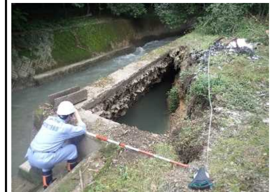
7月13日 護岸が被災した河川の現地調査 (熊本県錦町)
