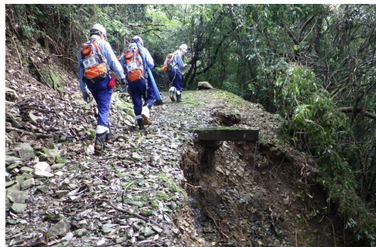
【球磨郡錦町：被災状況調査(河川班)】
