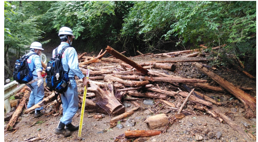
五木村道での被災状況調査
