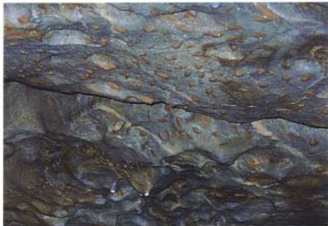
ムーンミルクの確認状況1 (西ホール1天井)
