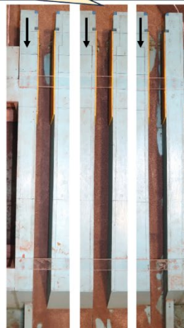
⑤ 通水後 河床部放流設備内
