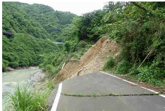
斜面崩壊の状況
