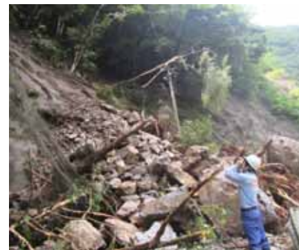
崩壊規模計測(レーザー計測) 【入鴨線 法面崩壊(H28)】
