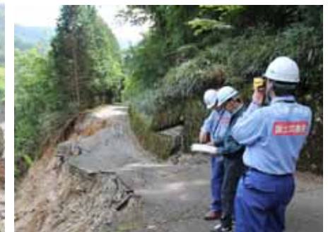
崩壊規模計測(レーザー計測) 【村道白蔵線 法面崩壊(H29)】
