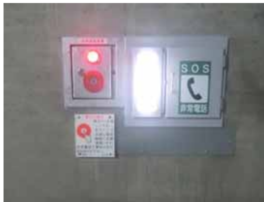
非常用電話、押しボタン通報装置
