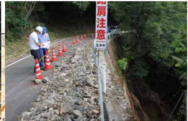
現地での工法検討に向けた 技術的助言（村道梶原線）
