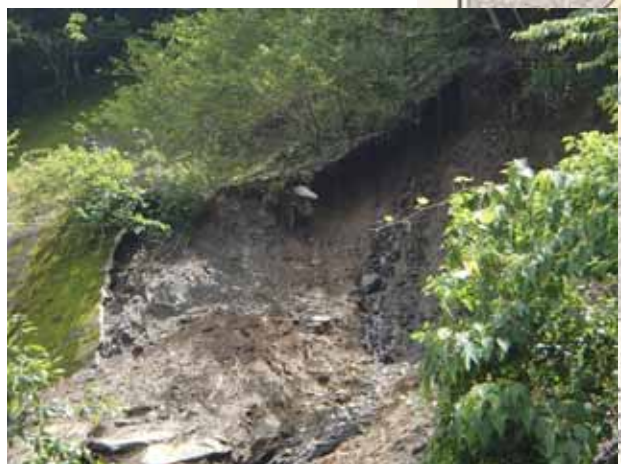
崩壊箇所の近景〔下流側から望む〕 【村道川辺川線】
