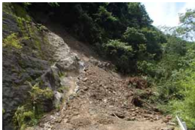
法面崩壊状況〔上流側から望む〕 【村道川辺川線】
