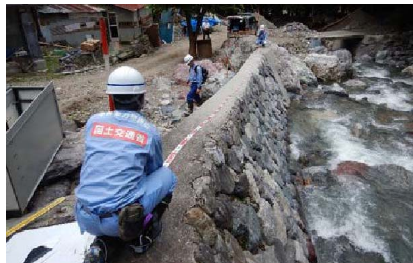
被災状況を調査(元井谷川)
