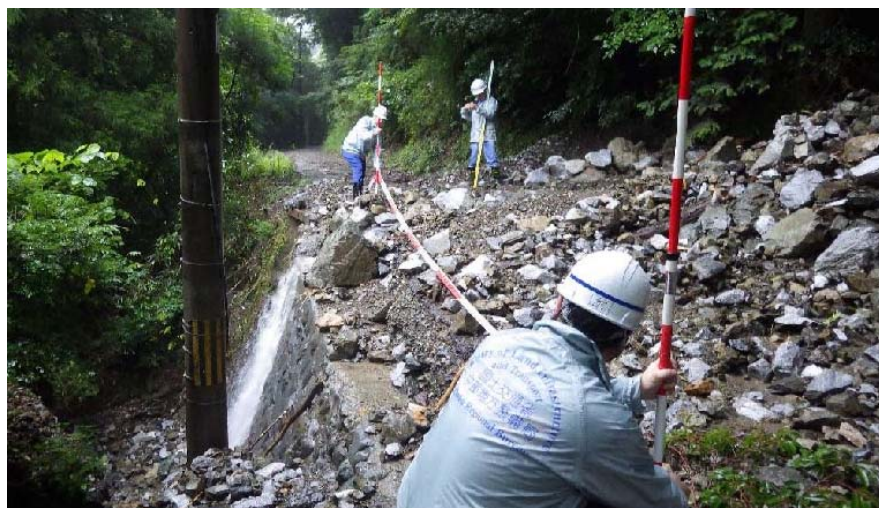
被災状況を調査(村道入鴨線)
