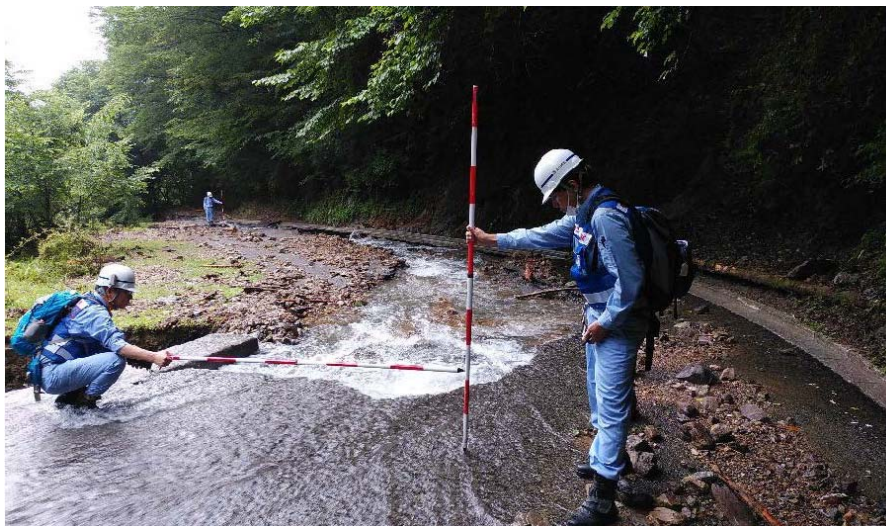
被災状況を調査(村道小鶴線)
