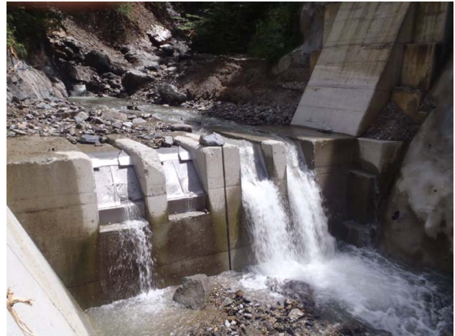
元井谷取水堰の被災状況
