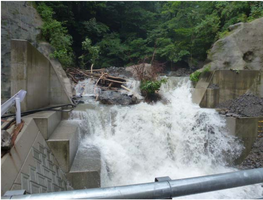
掛橋取水堰の被災状況
