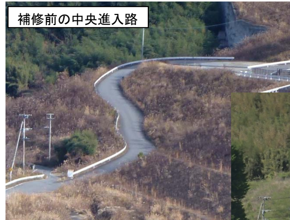
補修前の中央進入路
