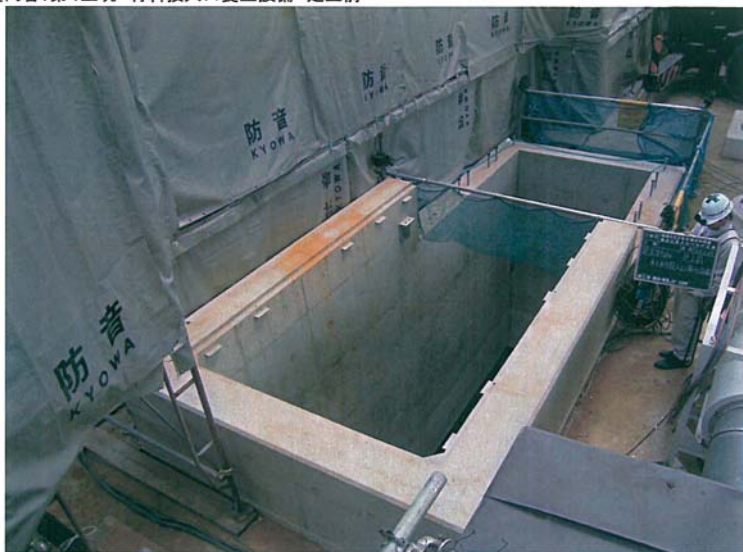
写真内容:第4立坑 材料投入口養生設備 是正前
