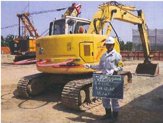
挟まれ防止バーの取り付け状況
