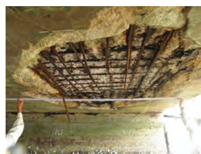
内部の鉄筋が露出した橋梁
