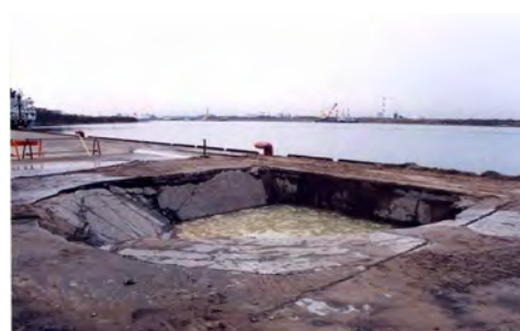
陥没した港湾施設のエプロン部分
