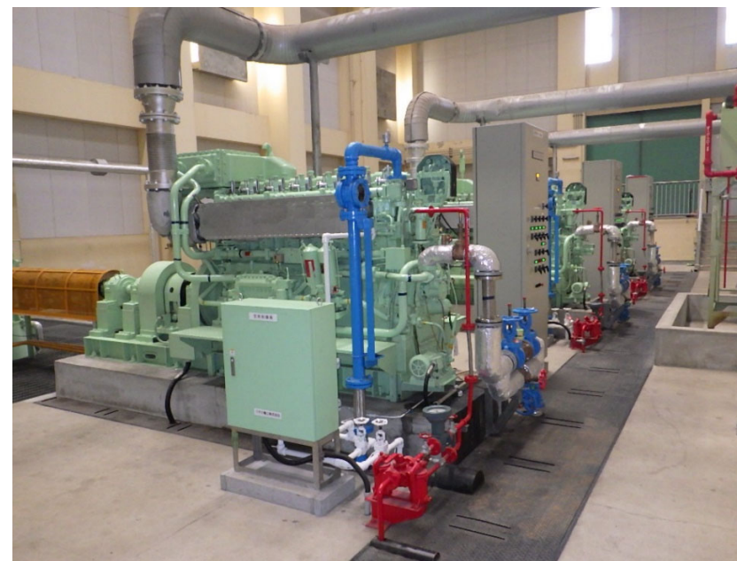
宗方ポンプ場 ポンプエンジン
