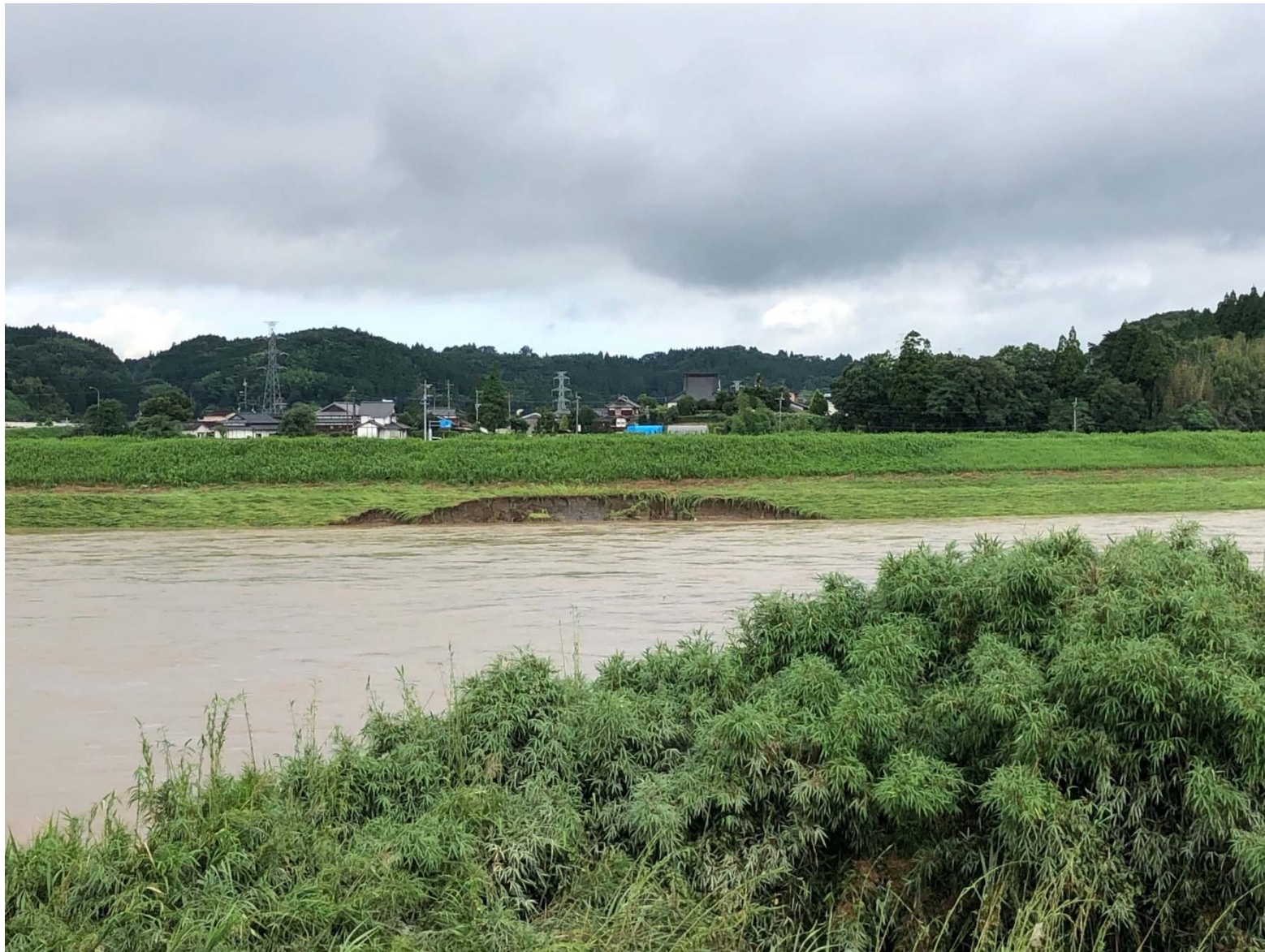
堤防表法面洗掘(菊池川右岸28k000付近)
