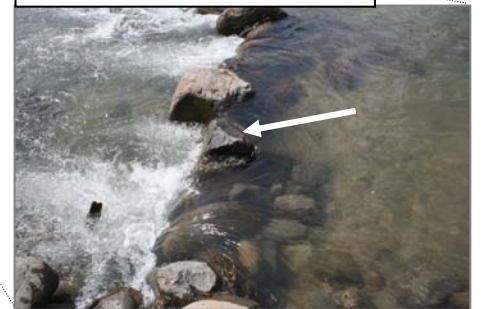
分散型落差工
