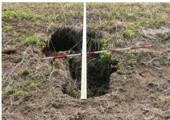
写真 2.1.7 堤防斜面の陥没
