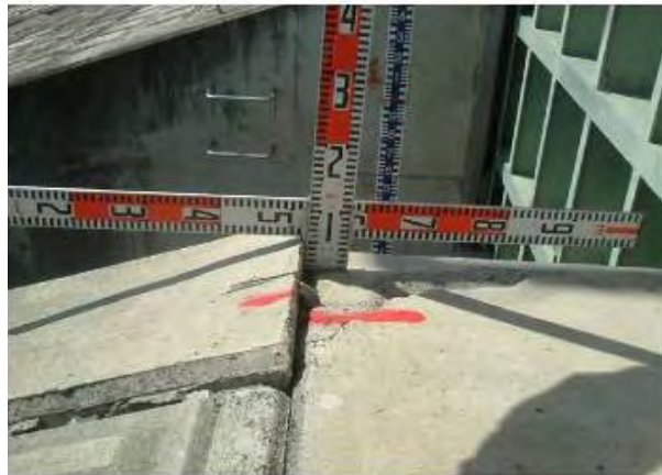
写真 2.1.12 樋門・樋管のひび割れ状況
