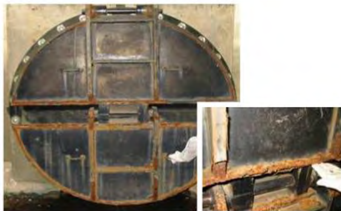
写真 2.1.11 排水ポンプ場内の施設腐食状況
