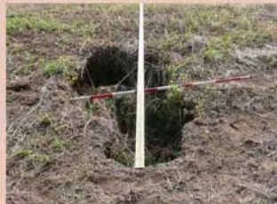
モグラによる堤防の陥没 (菊池川 右岸 25k370 付近)
