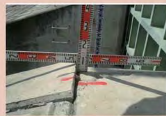
樋門・樋管のひび割れ状況
