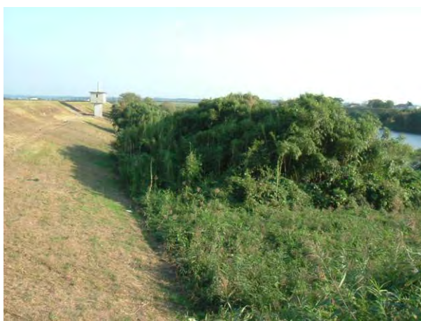
写真 4.3.1 樹木繁茂状況 (菊池川 37k 付近)
