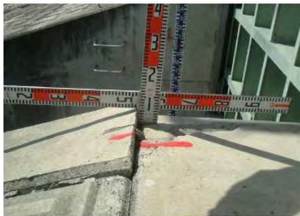
写真 2.1.12 樋門・樋管のひび割れ状況
