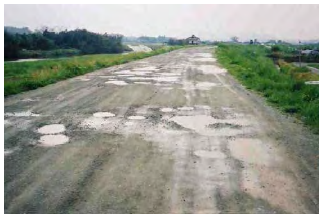
写真 2.1.10 堤防上面損傷による水たまり
