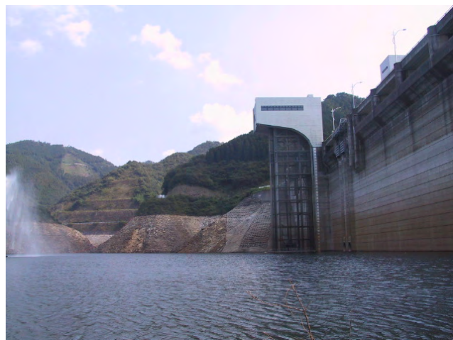
写真 4.3.7 竜門ダム選択取水設備
