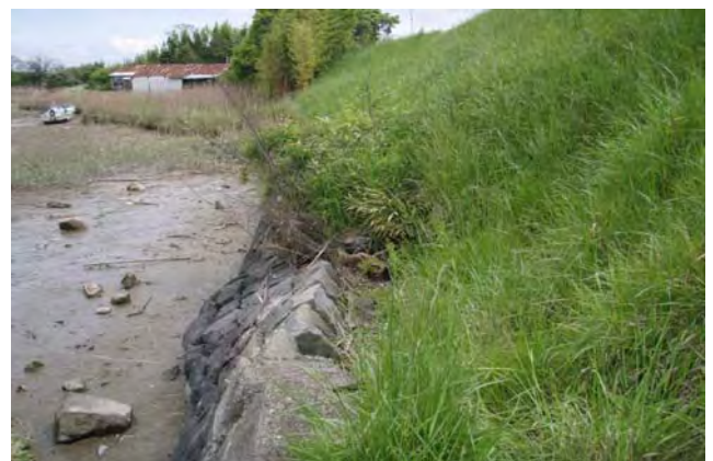
写真 2.1.8 堤防護岸の損傷
