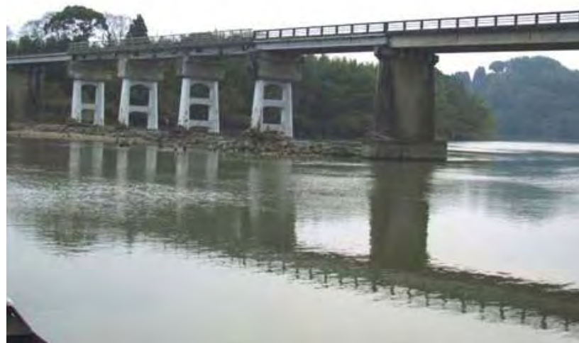
写真 2.1.2 流下阻害となっている内藤橋
