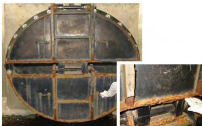
写真 2.1.11 排水ポンプ場内の施設腐食状況
