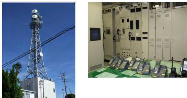
写真 4.3.17 通信ネットワーク設備群
