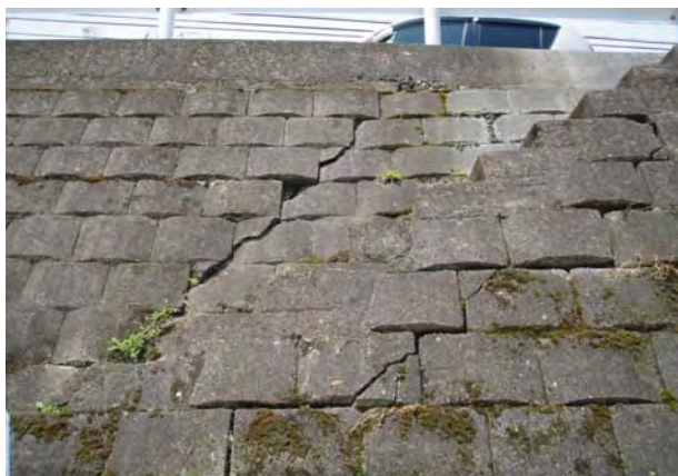
写真 2.1.9 堤防護岸のひび割れ
