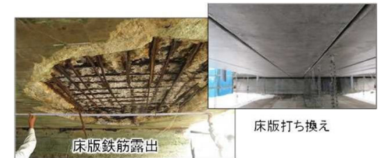
道路施設の老朽化対策
