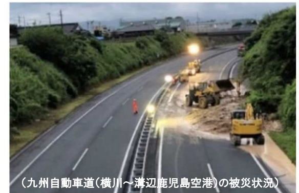
（九州自動車道（横川～溝辺鹿兒島空港）の被災状況） 暫定2車線区間の4車線化等による道路ネットワークの機能強化対策
