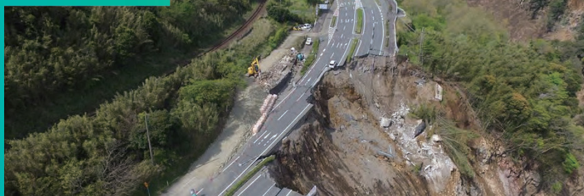
国道 57 号の被災状況
