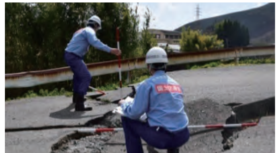
▲県道149号の被災調査
