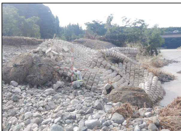
被災状況緊急調査(緑川)
