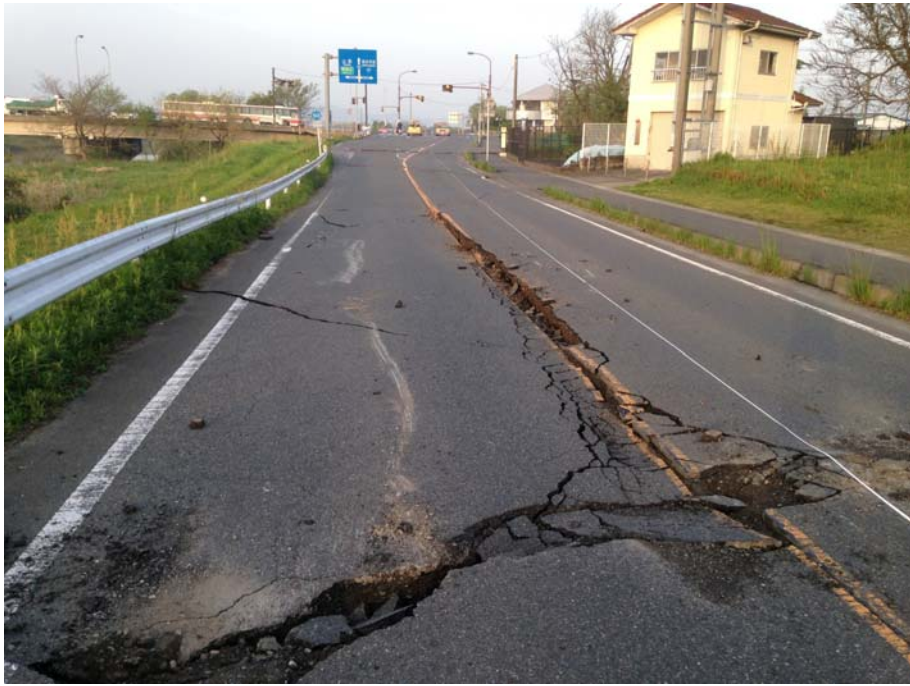
被災状況（平成28年4月15日撮影）
