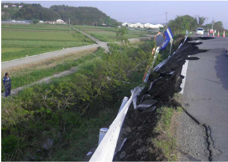
被災状況（平成 28 年 4 月 15 日撮影）
