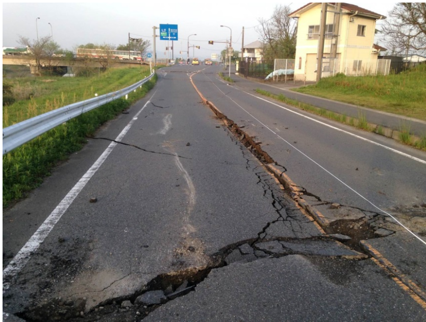
被災状況（平成 28 年 4 月 15 日撮影）
