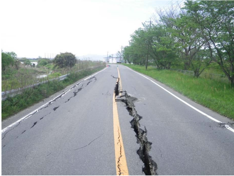
被災状況（平成 28 年 4 月 16 日撮影）
