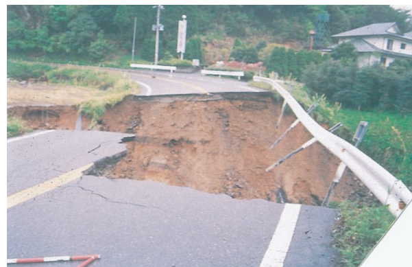
【国道445号 過去の被災状況】
