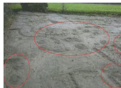
漏水による噴砂の例
