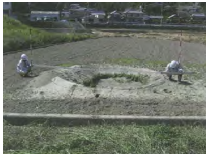
漏水による噴砂の例
