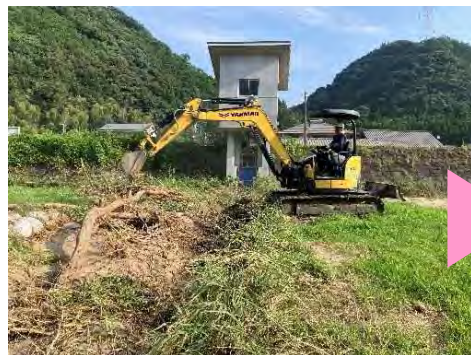
堆積した塵芥 (着手前)
