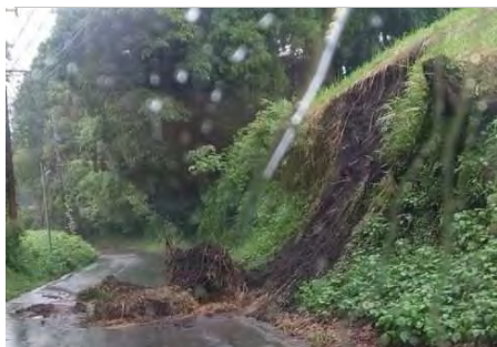
仮宿地区の法面崩壊
