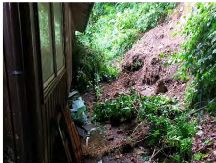
民家敷地裏の被災写真
