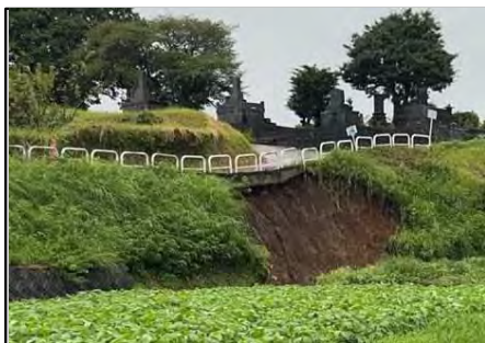
鳥子川地区の法面崩壊
