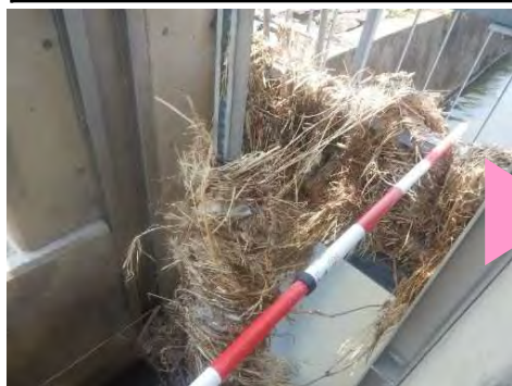
堆積した塵芥(着手前)
