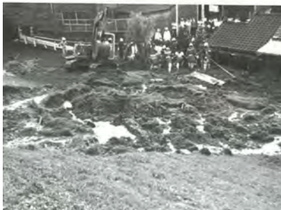
排水不良による法すべり
