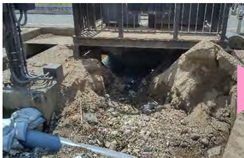
堆積した土砂 (着手前)
