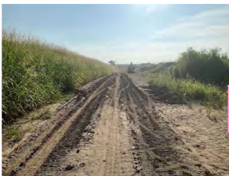
堆積した土砂(着手前)
