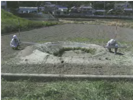
漏水による噴砂の例
