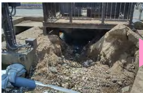
堆積した土砂(着手前)
