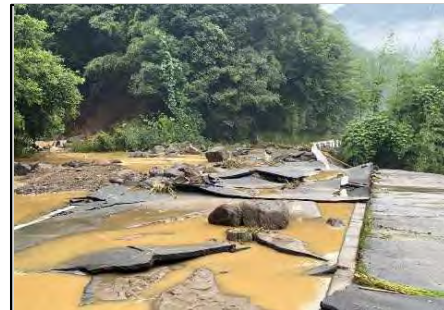
道路崩壊 (宮内地区)
