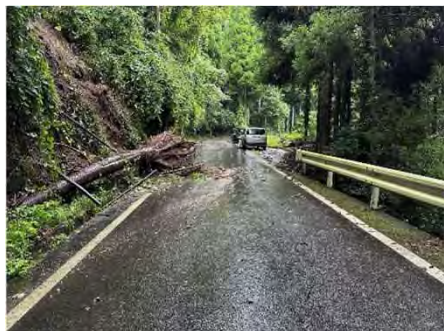
町道被災写真
