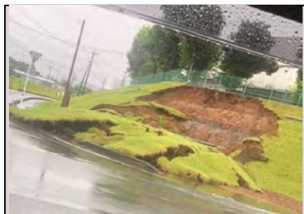
入道水地区の法面崩壊
