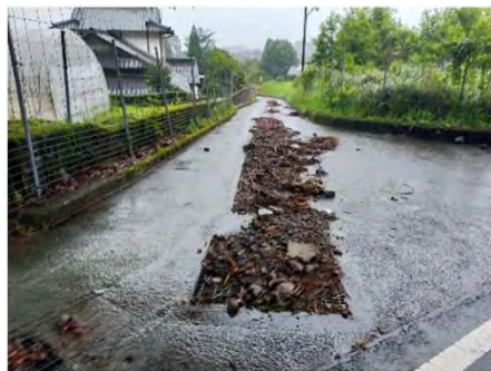
町道被災写真
