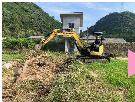
堆積した塵芥(着手前)
