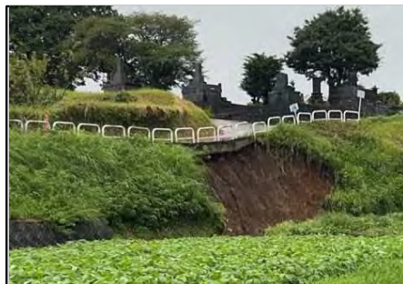
鳥子川地区の法面崩壊
