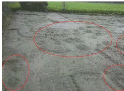
漏水による噴砂の例
