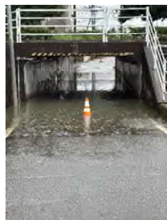
鯨地区巡視 アンダーパス冠水
