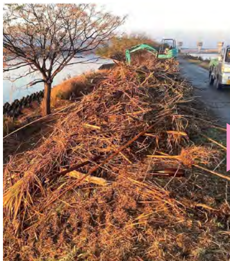
堆積した塵芥(着手前)
