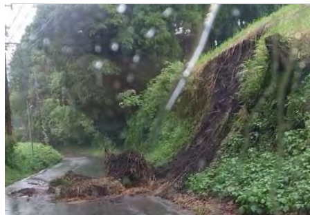
仮宿地区の法面崩壊
