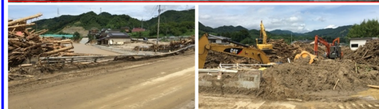
福岡県赤谷川被災状況
